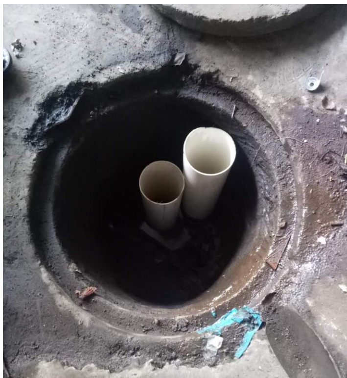
图 4-3 雨水总排口闸门
