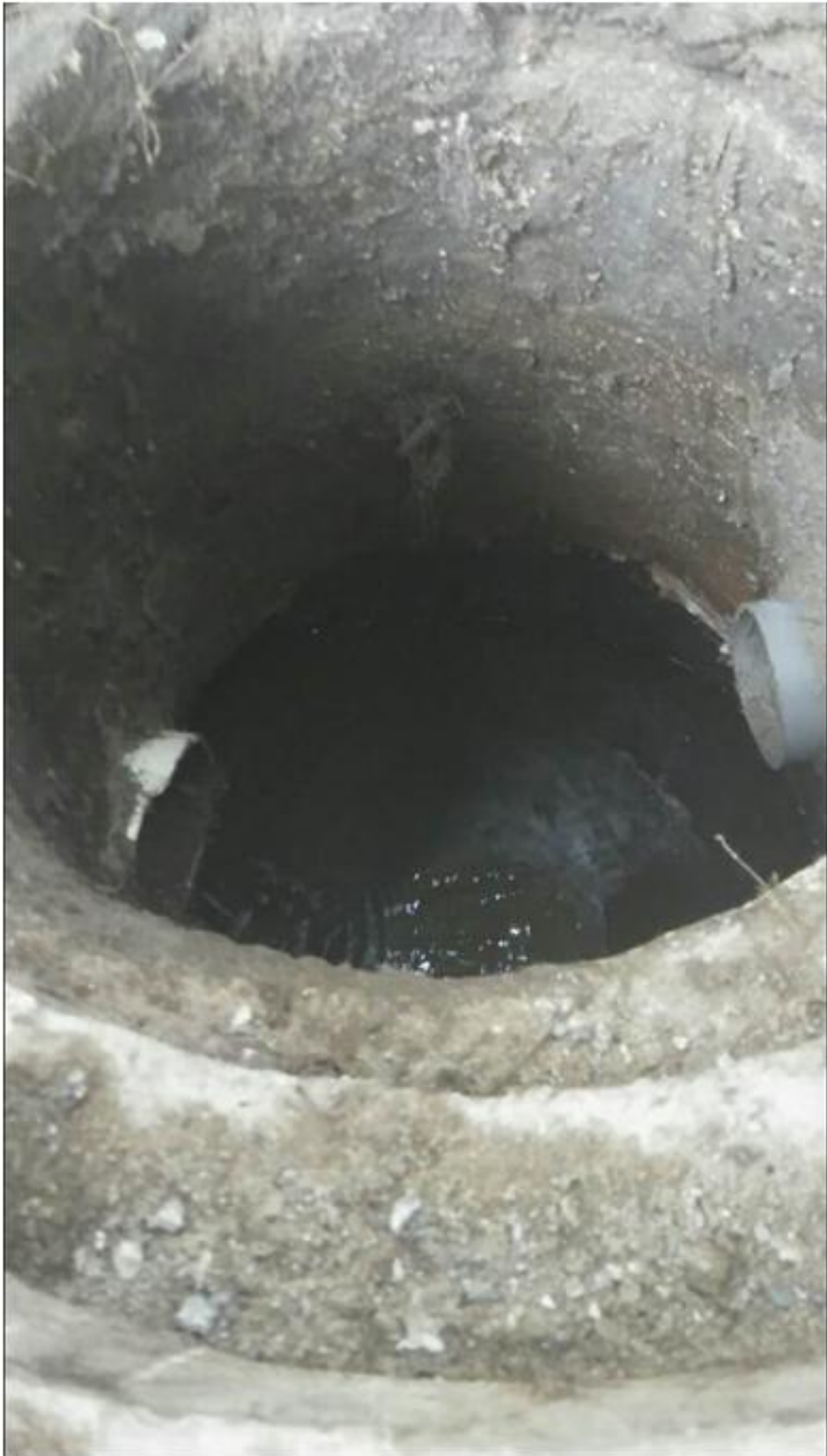
凯泰连接旺铁事故应急池的应急管道
